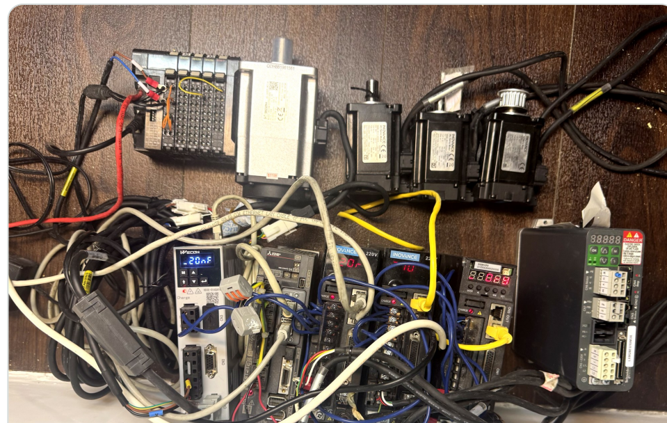
Стенд: коуплер Omron, приводы Mitsubishi, Inovance и Wecon на одной шине EtherCAT
